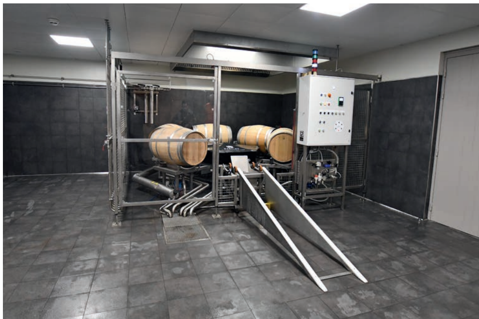
LAVEUR BARRIQUES BARILAV ROTATIF Château Troplong Mondot (Saint-Emilion) INSTALLATION 2020
